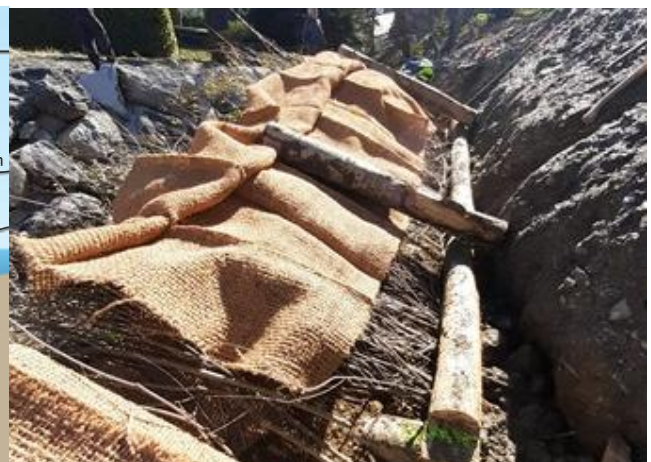
Fig. 15 : Installation de boutures de saule et de boudins de coco entre les longrines avant dépôt de terre et recouvrement avec la toile (Dupin, 04/12/25).
