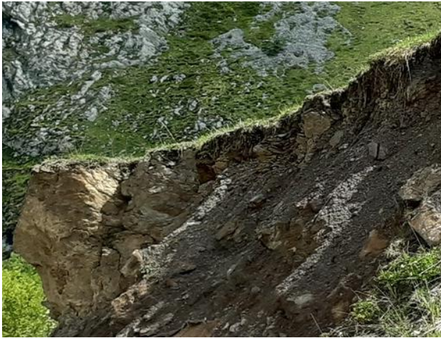
Zone non aménagée soumise à l'érosion (22/05/24)
