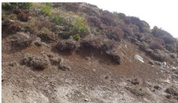
Erosion régressive du talus au début du printemps à Béost (12/04/21)
