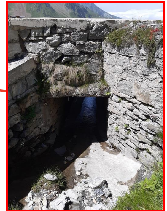
Buse d'évacuation sous-dimensionnée
