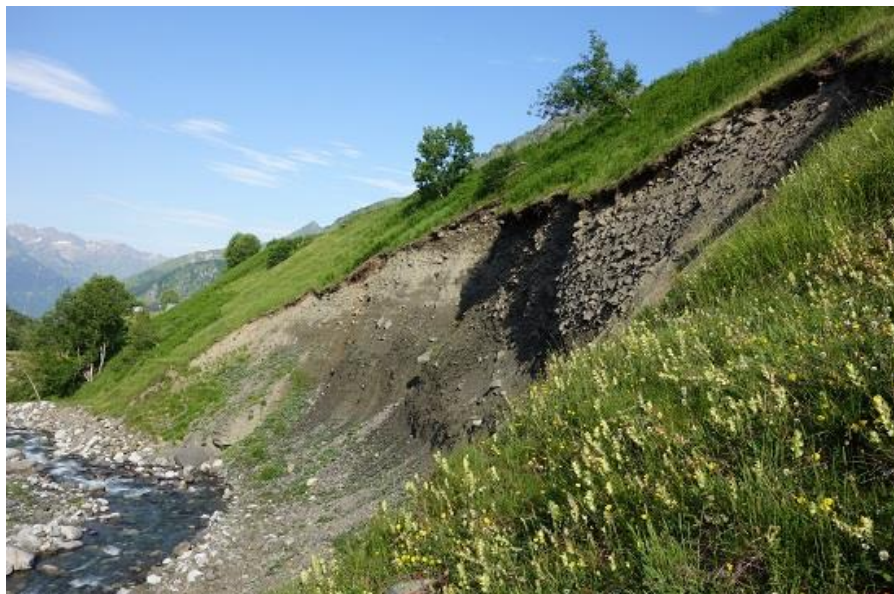
Glissement sur berge du Bastan vu de profil (24/06/2020).
