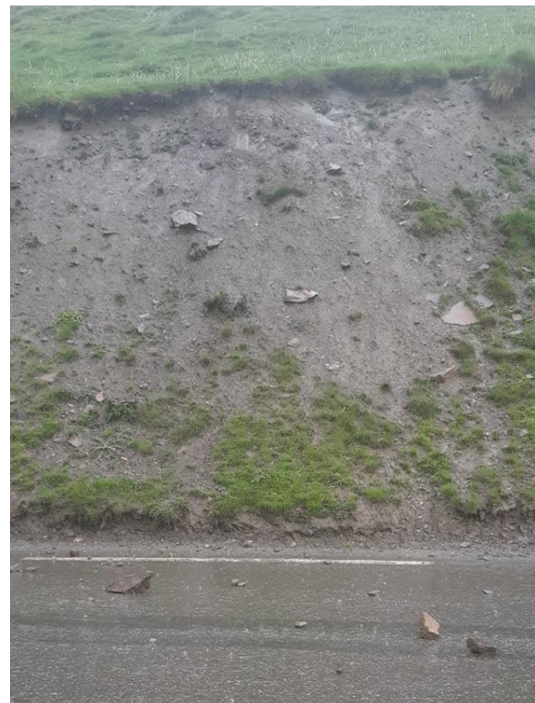
Chute de cailloux sur la chaussée (13/06/2023)
